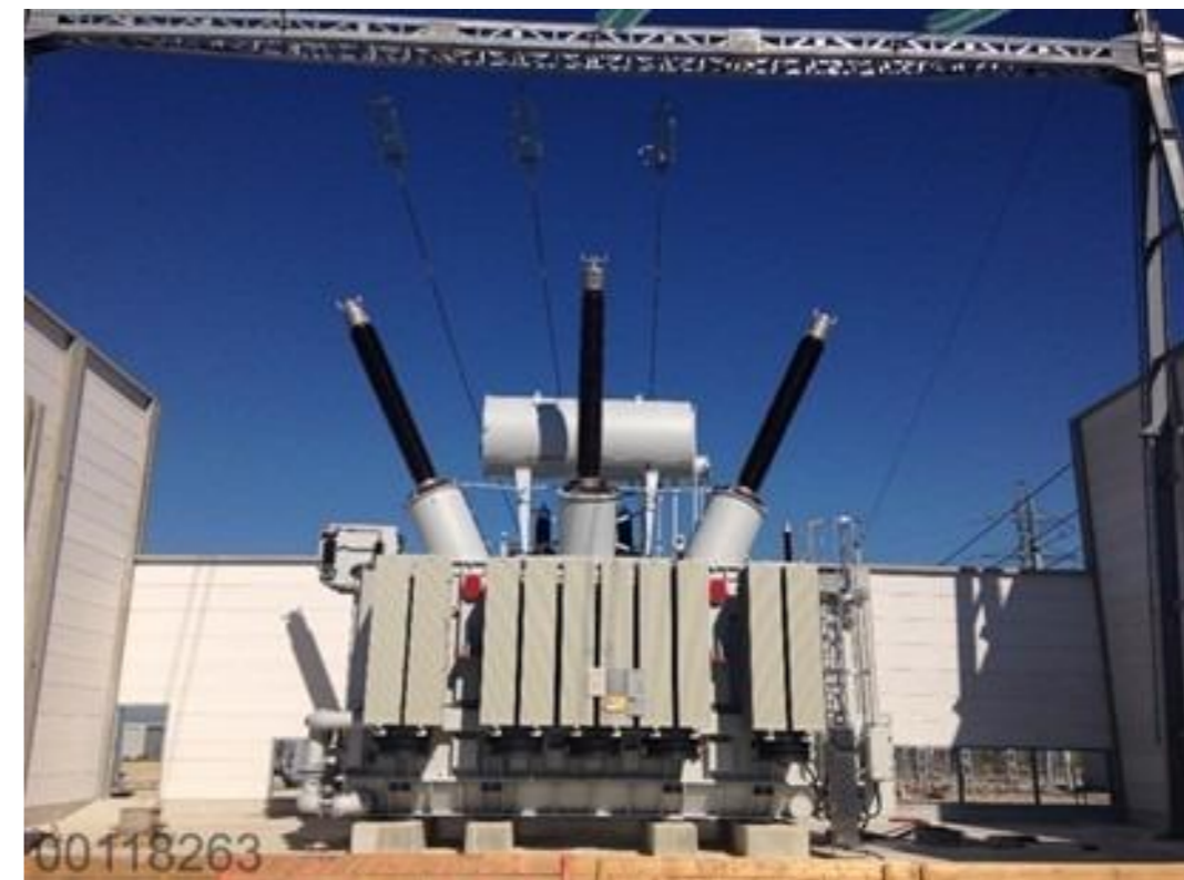
Figure 3-100 Exemple de transformateur 400/90 kV
