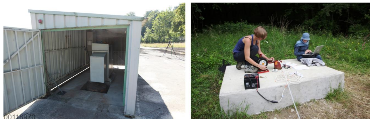
Figure 3-123 Centrale d'acquisition de données dans un cabanon de protection de forage (à gauche) et tête de piézomètre (à droite)
