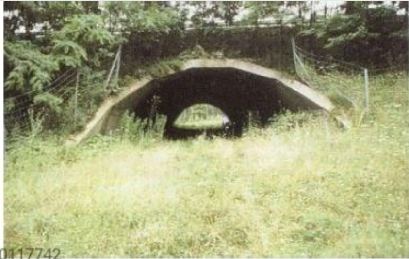
Figure 6-9 Exemple de dispositif de busage pour le passage de la petite faune sous voirie 2
