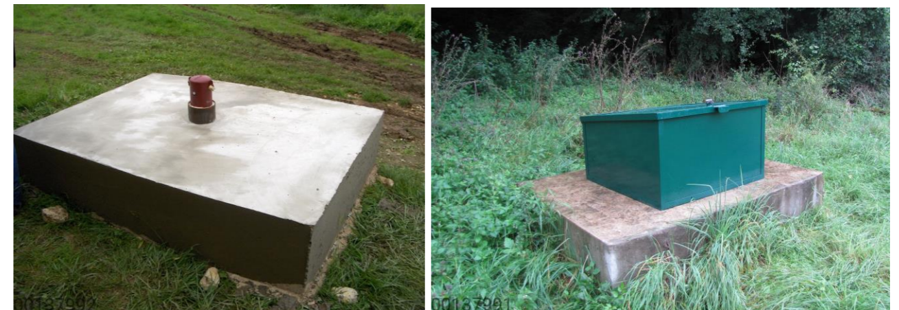
Figure 14-99 Exemple de piézomètre équipé d'une tête métallique sur une dalle béton sans coffret de protection (à gauche) et exemple de piézomètre équipé d'un coffret de protection installé sur une dalle béton (à droite) (source Andra)
