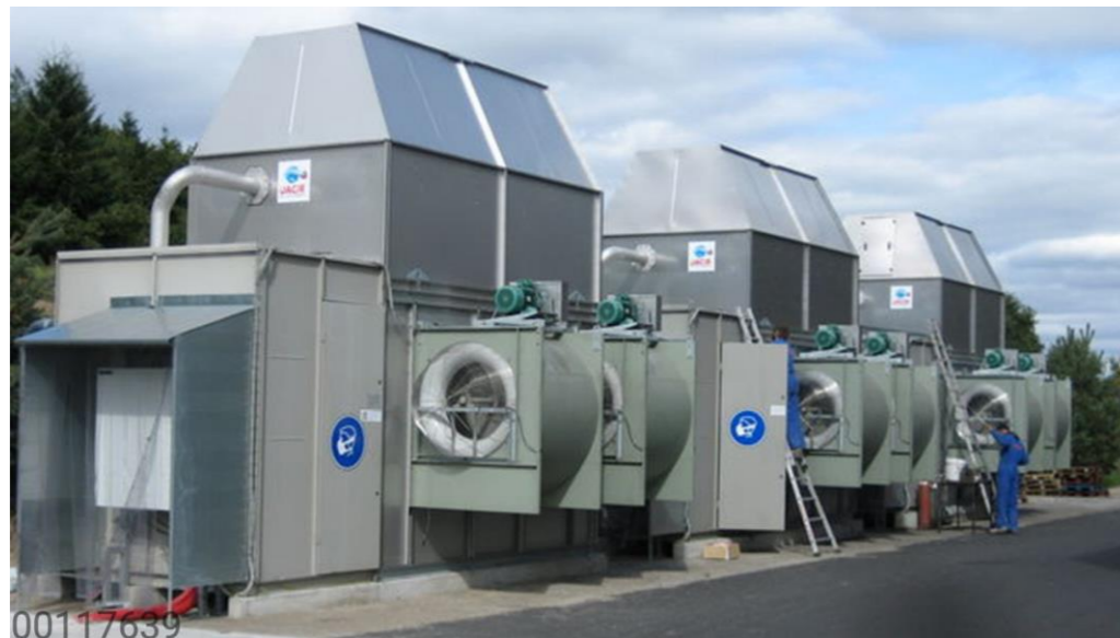
Figure 3-3 Photographie illustrative de refroidisseurs à circuit fermé
