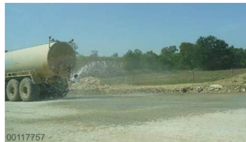
Figure 4-13 Arrosage des pistes pour limiter l'envol de poussières par temps sec (Source : Egis)
